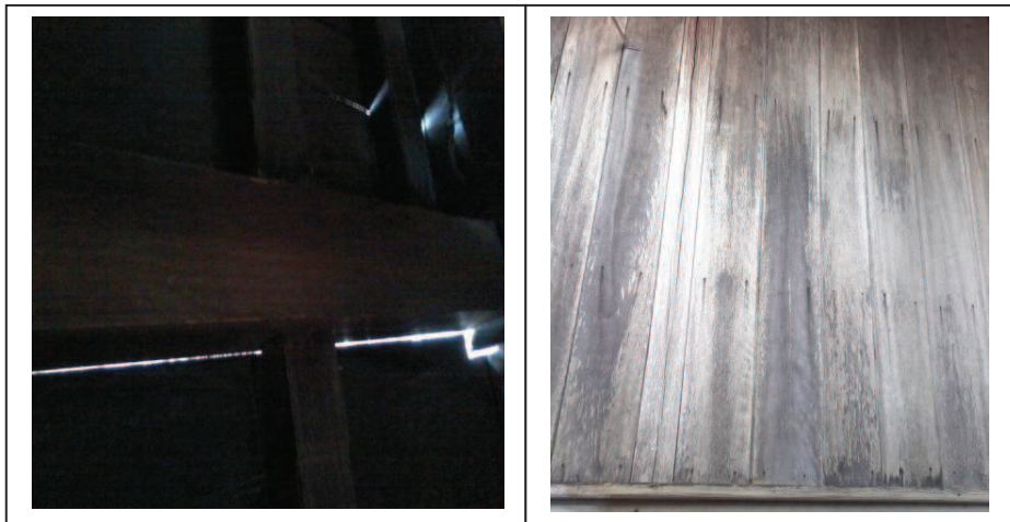
Gambar: Konstruksi dinding yang berbahan dari kayu yang ditata sejajar menyerupai garis vertikal (Sumber: Data Lapangan, Penulis)
