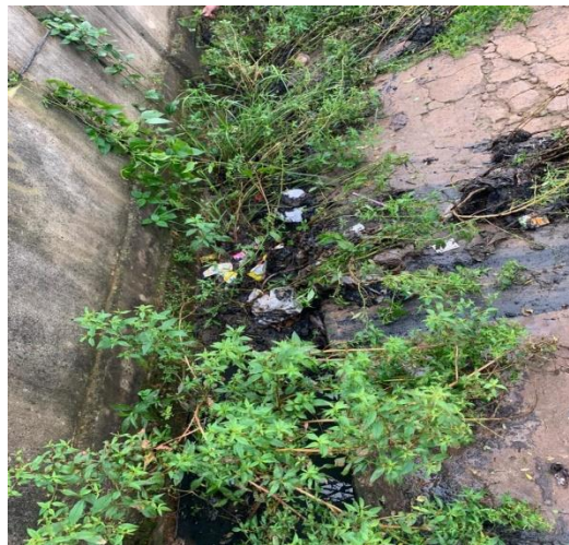
Gambar 4.2 Sampah yang berserakan di selokan Jalan PMD KM 12
